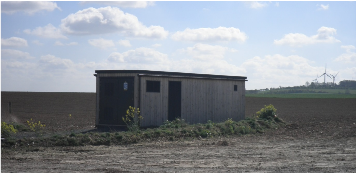
Figure 8 : Exemple de poste de livraison qui sera mis en place
