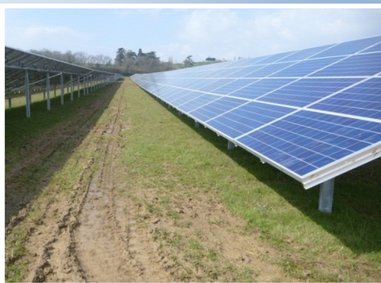
Centrale Solaire de CONDOM Département : Gers (32) Puissance électrique : 10 000 KWc Mise en service : Mars 2013
